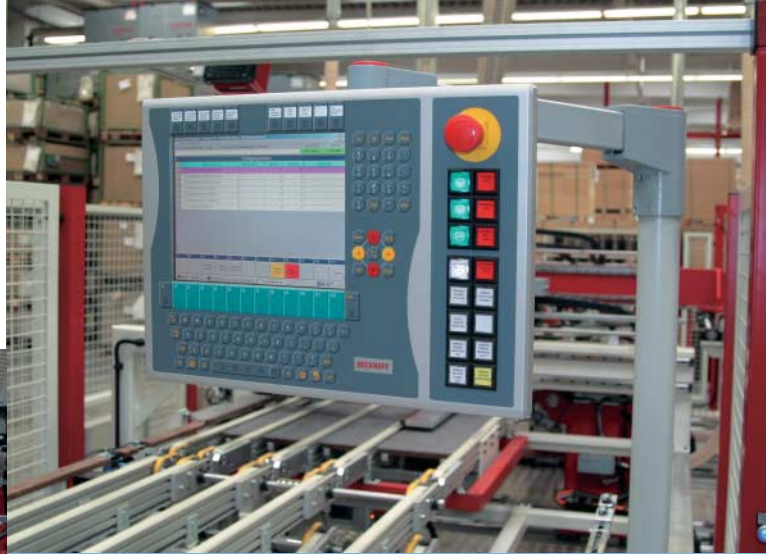
Display der zentralen Maschinen- und Anlagensteuerung
