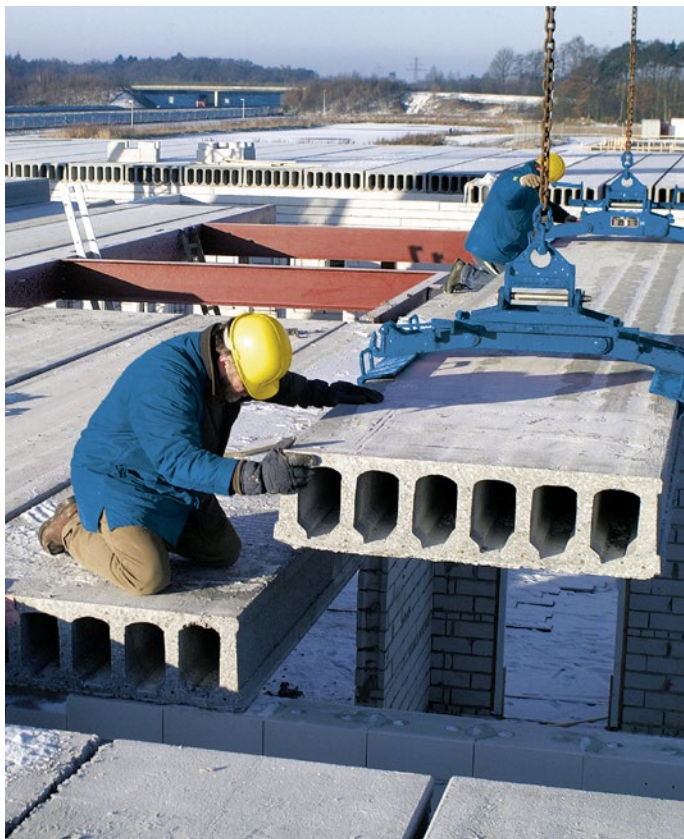
Die Spannbetonhohldecken werden, auf Maß zugeschnitten und mit den erforderlichen Aussparungen für Rohrleitungen und Elektrik versehen, an der Baustelle angeliefert.
