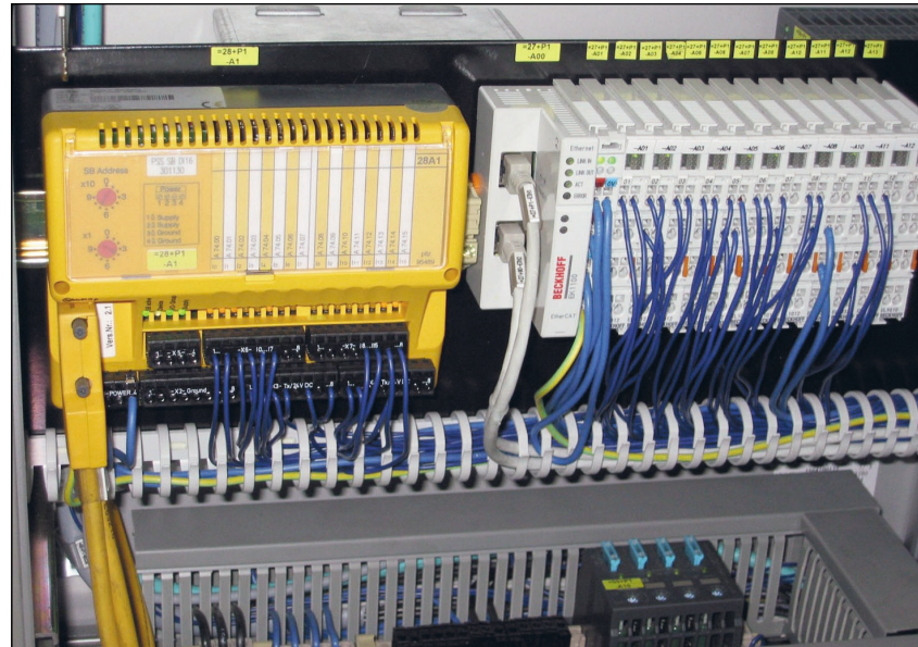
Blick in den Steuerungs-PC: rechts die Ethercat-Klemmen, links die dezentralen E/A-Module der Sicherheitssteuerung.
